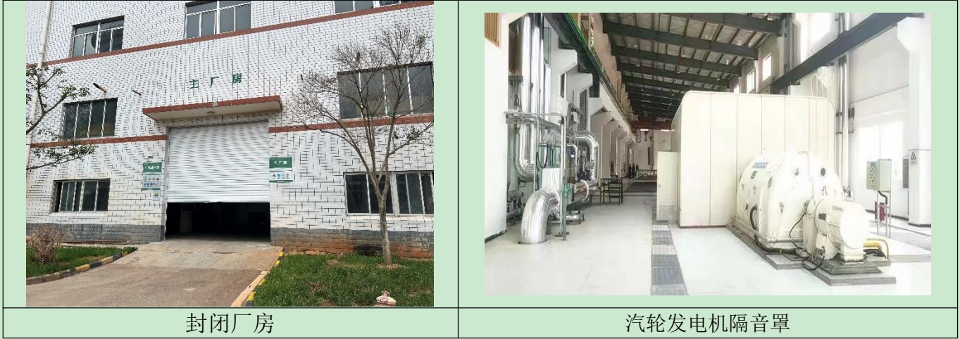
图 4.1-5 厂区隔声设施
