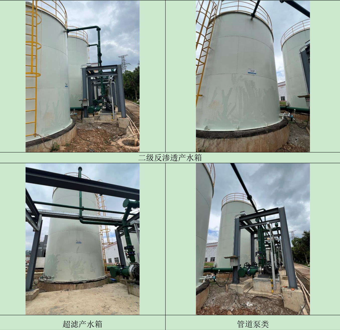
图 4.1-2 工业废水处理站设施图
