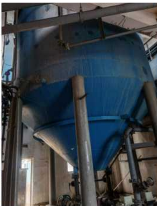
脱硫废水收集处理罐
