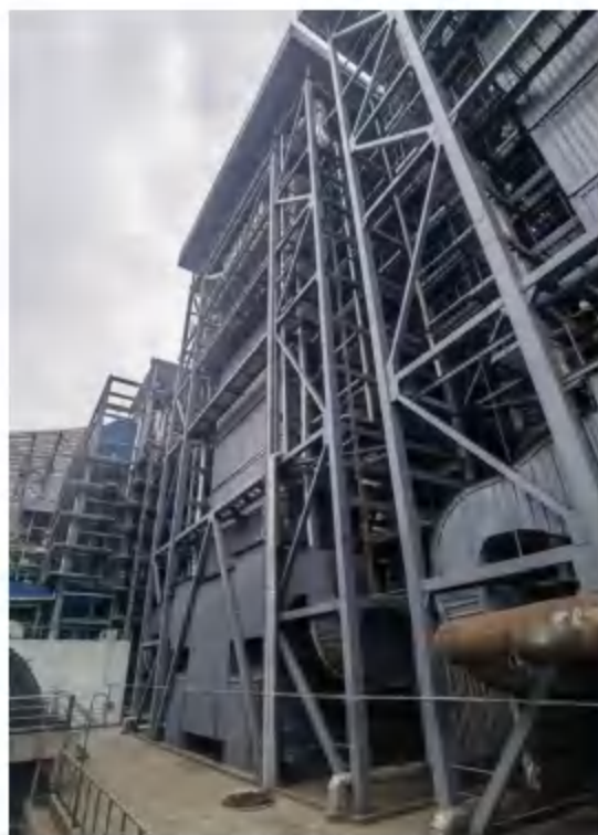
废气处理设施
